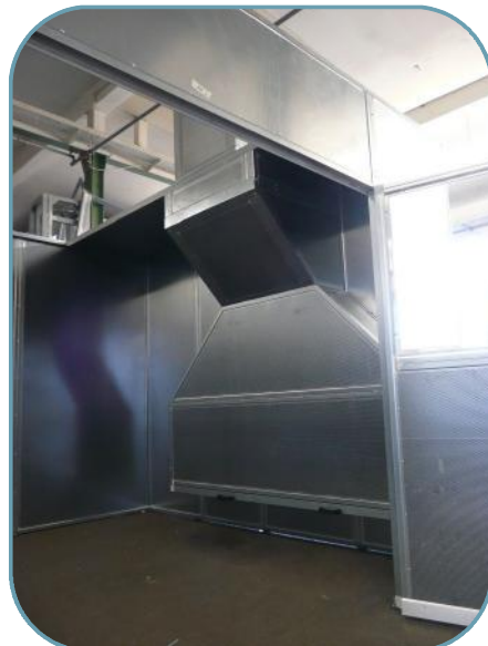
Absaugkulisse mit Abluftkamin für CO2 Reinigung
